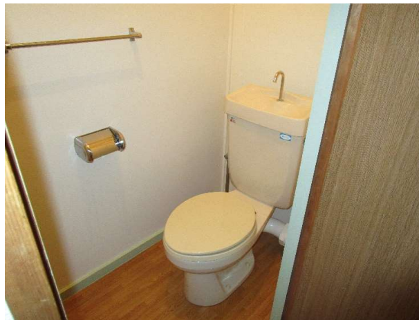
便所 (コンセントあり)
