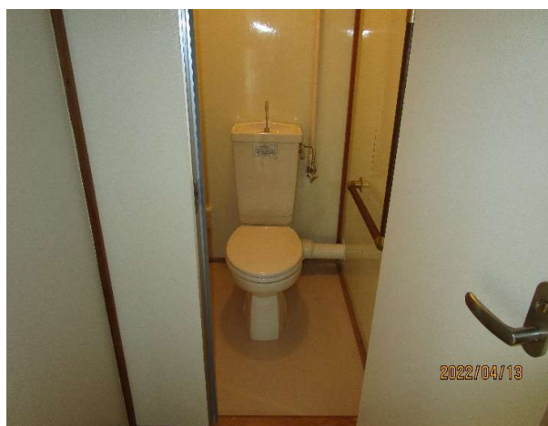
便所 (コンセントあり)
