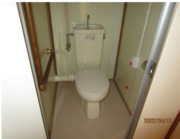
便所 (コンセントあり)
