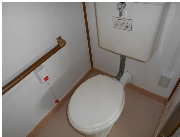
便所 (コンセントあり)
