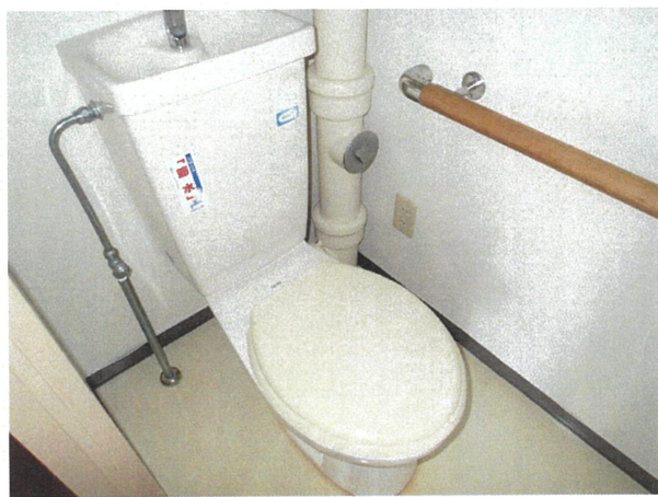
便所 (コンセント有り)
