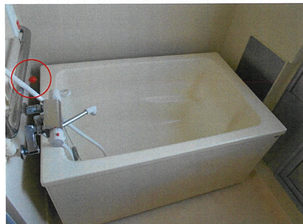
浴室(赤丸は非常呼出しです)
